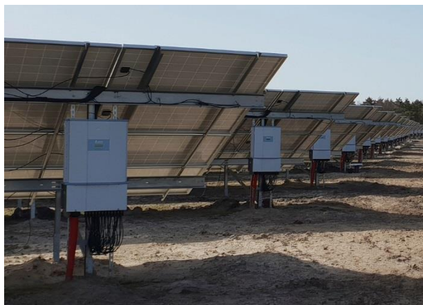
Figur 6. Eksempel på inverterer der sidder under solpanelerne.
