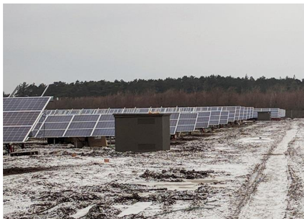
Figur 5. Eksempel på fordelingstransformere, her opstillet i forbindelse med solceller på den nedlagte flyveplads i Vandel.
